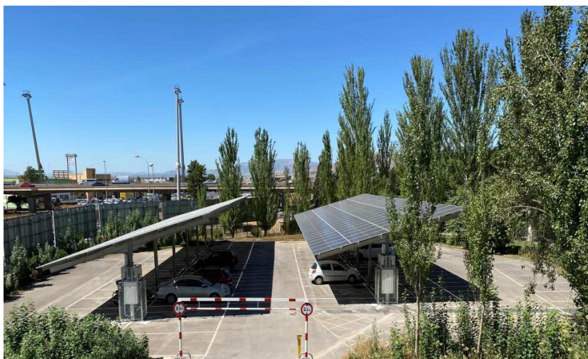
Fonte: dal partner DPG. Impianto fotovoltaico nel parcheggio di proprietà.
